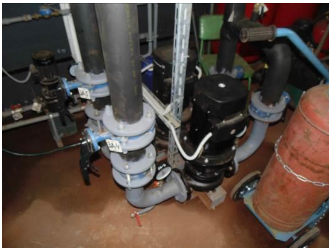
Рисунок 1.2.1.6. Насосное оборудование котельной 1,0 МВт.
