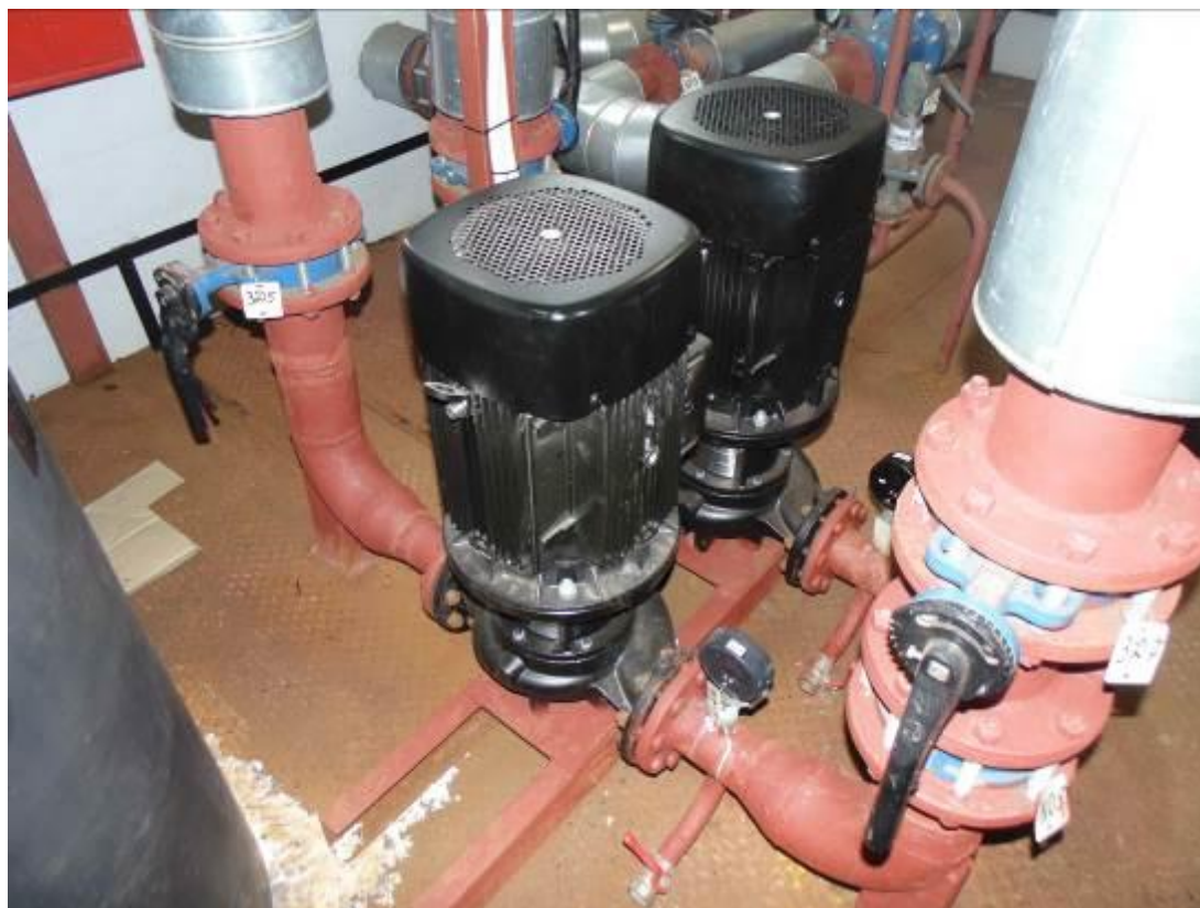
Рисунок 1.2.1.3. Насосное оборудование котельной 2,7 МВт.
