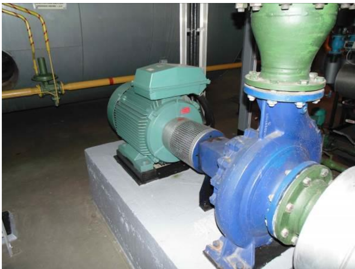
Рисунок 1.2.1.11. Насосное оборудование котельной №62.
