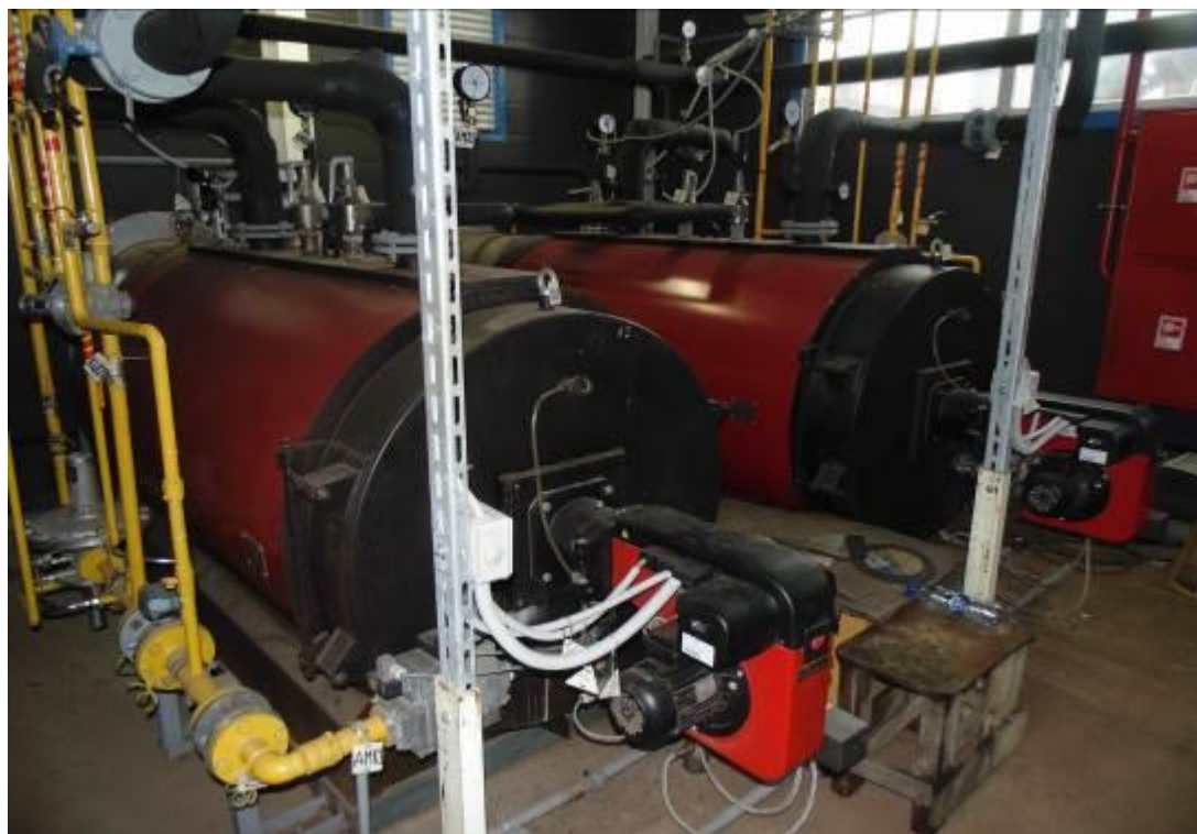
Рисунок 1.2.1.5. Котловое оборудование котельной 1 МВт.
