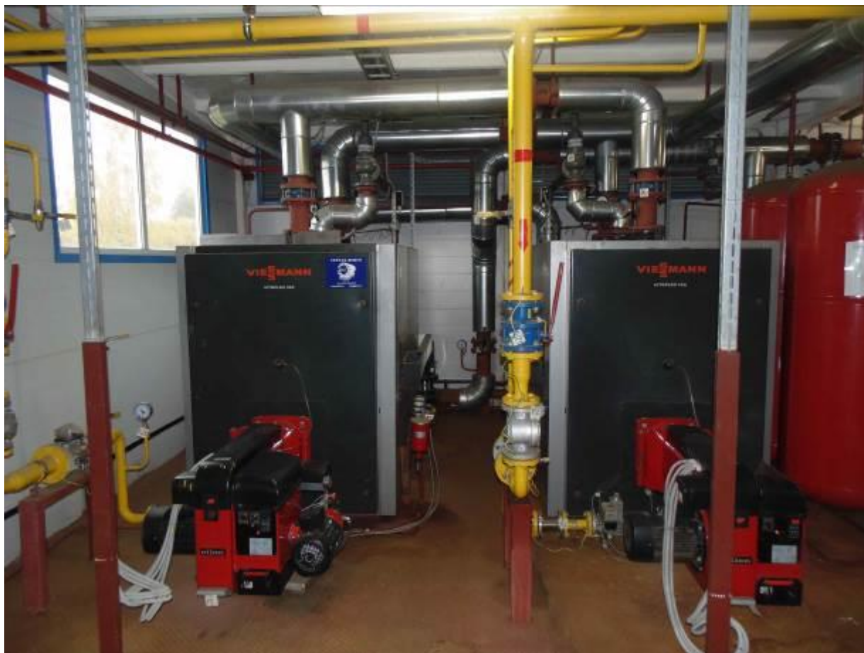
Рисунок 1.2.1.2. Котловое оборудование котельной 2,7 МВт.
