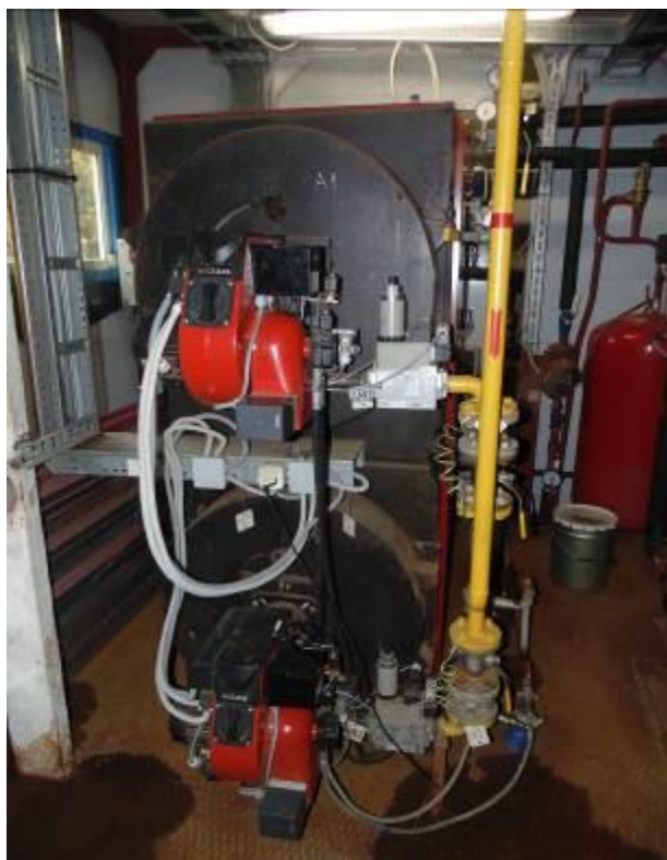
Рисунок 1.2.1.8. Котловое оборудование котельной 0,5 МВт.
