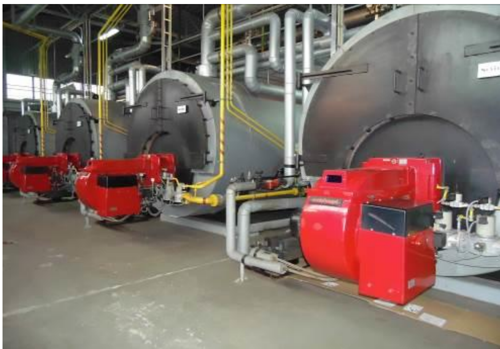
Рисунок 1.2.1.10. Котловое оборудование котельной №62.
